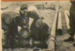
Les travaux complètent le pipeline qui a été en service à l'été. Également visible la ligne souterraine qui transporte le pétrole de la mer au port.
