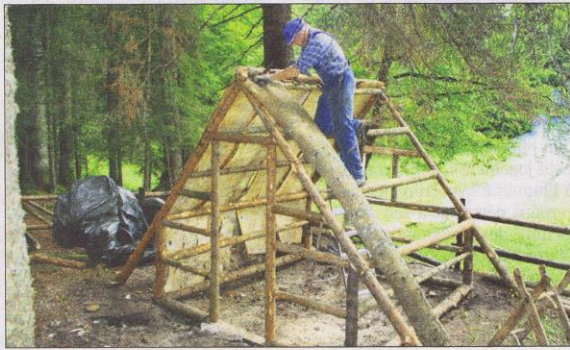
Rémy Rochat pose une plaque d'écorce fraîche. Avec ses quelques trois mètres de long, elle couvrira le pan de toit et le bout de façade.
